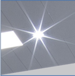
Éclairage de secours
