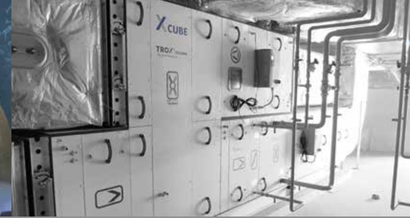
21 Klimazentralgeräte der Serie X-CUBE versorgen das Museum pro Stunde mit rund 130.000 m 3 konditionierter Luft. (Abb. TROX)
