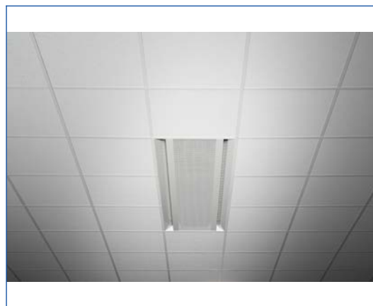
Inbouw in systeemplafond
