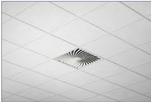
Inbouw in systeemplafond
