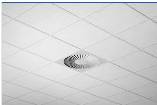
Inbouw in systeemplafond
