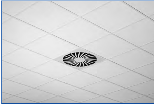
Inbouw in systeemplafond
